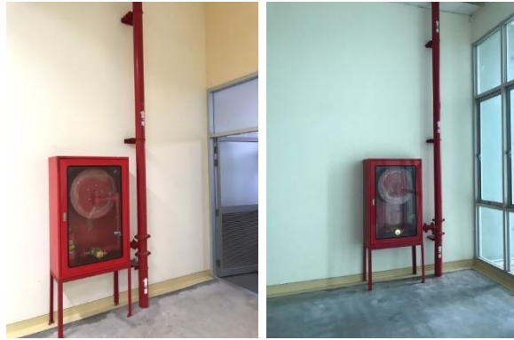
ภาพ แสดงพื้นที่ตั้งถังดับเพลิง สายดับเพลิงที่ไม่มีสิ่งกีดขวาง
