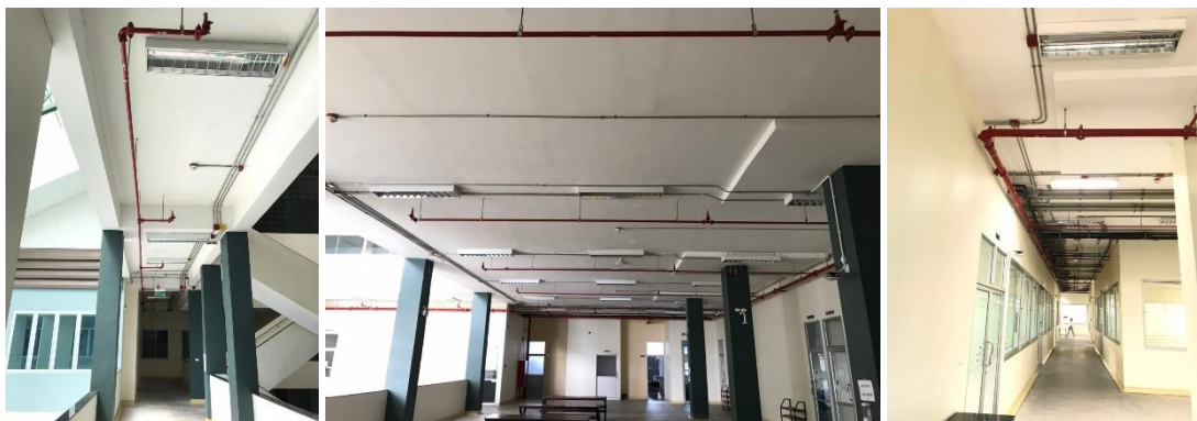
ภาพ สปริงเกอร์ดับเพลิง
