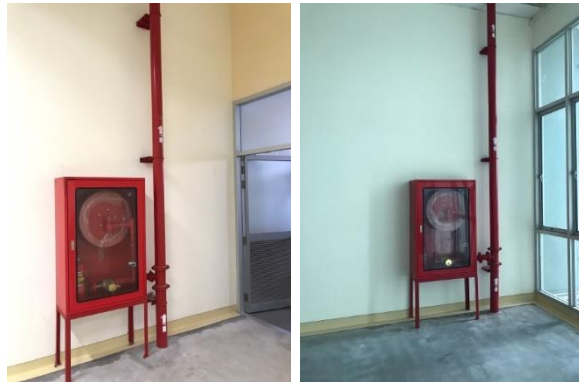
ภาพ แสดงพื้นที่ตั้งถังดับเพลิง สายดับเพลิงที่ไม่มีสิ่งกีดขวาง
