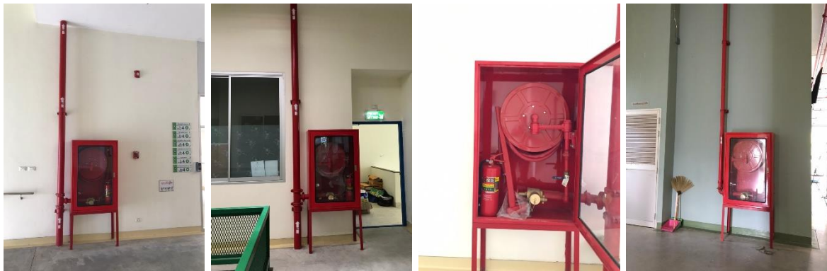
ภาพแสดงที่ติดตั้งถังดับเพลิง
