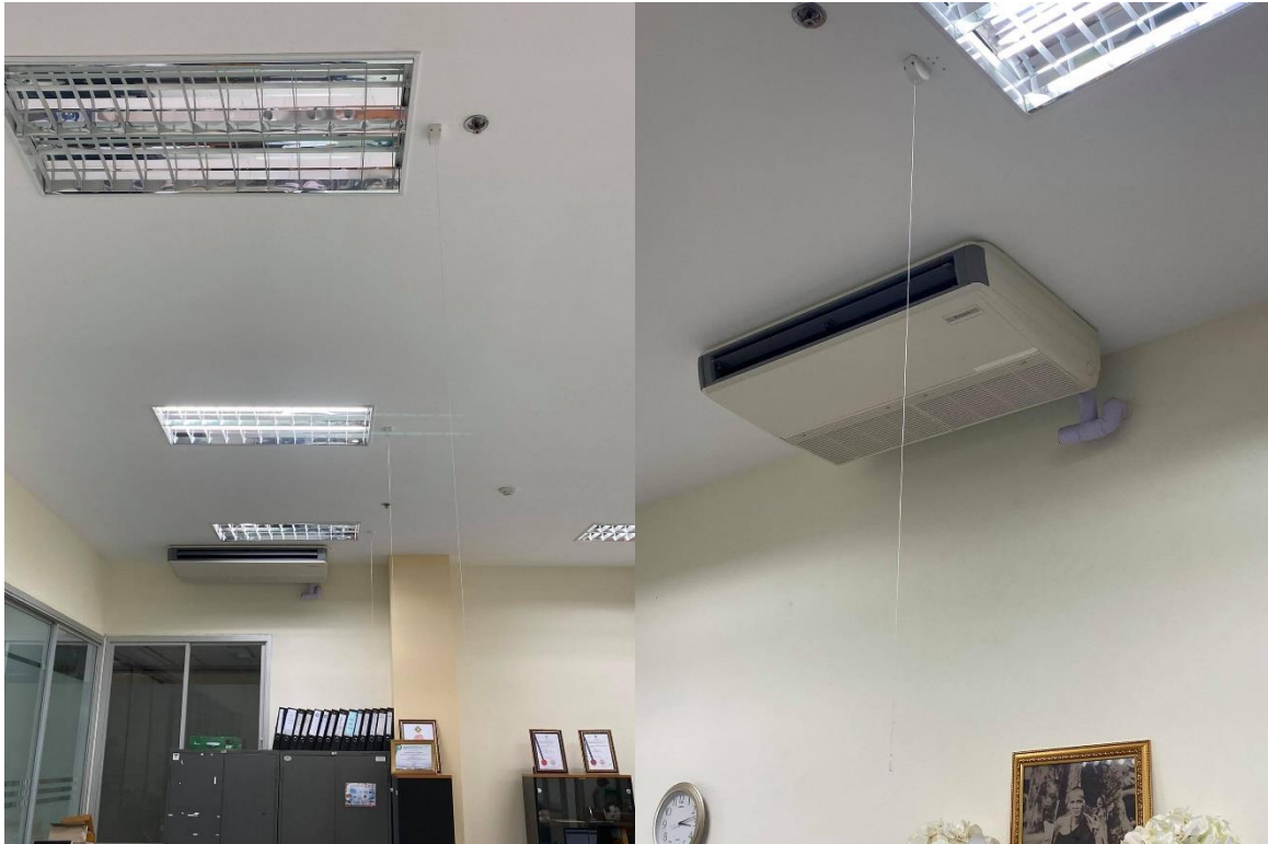
การติดตั้งสวิทช์กระตุกสำหรับการประหยัดพลังงานเฉพาะพื้นที่
