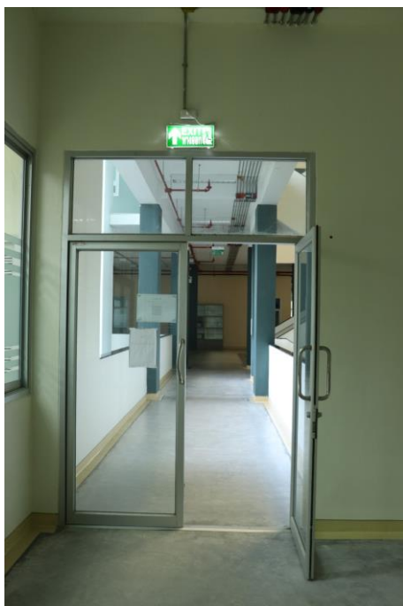
ภาพ ป้ายทางหนีไฟ
