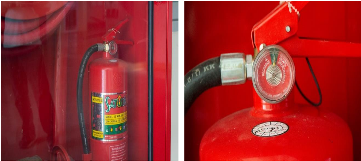
ภาพ การตรวจถังดับเพลิง
